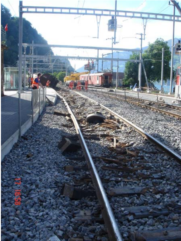
Zerstörte Gleisanlage zwischen dem Bahnübergang und den entgleisten Wagen in Mühlehorn.
