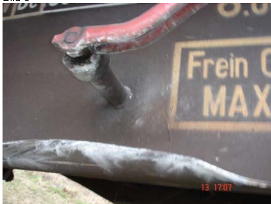
Der Bremsausschalthebel am Hbis weist massive Schlagspuren auf und dürfte durch den Anprall auf der Abschlussmauer in die Stellung ‚Aus‘ gedrückt worden sein.
